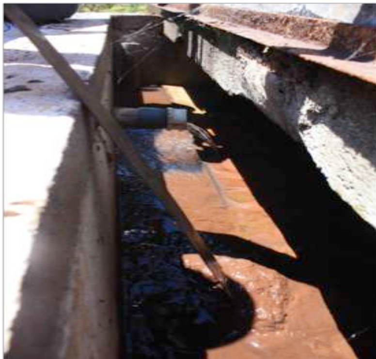
Figura 47. Foto del tanque della Vertiente Santa Rosa. L'acqua che arriva dalla fonte attraverso il tubo sembrerebbe limpida e pulita, ma all'interno del serbatoio è ben visibile la torbidità e la sedimentazione di particelle sul fondo.
