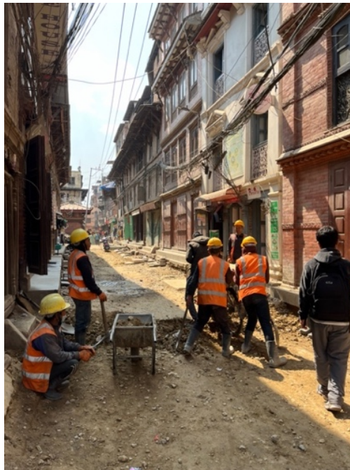
Figura 3.12- strada in fase di restauro dopo al terremoto de 2015 (Foto di Marianna Cerrina 2024)
