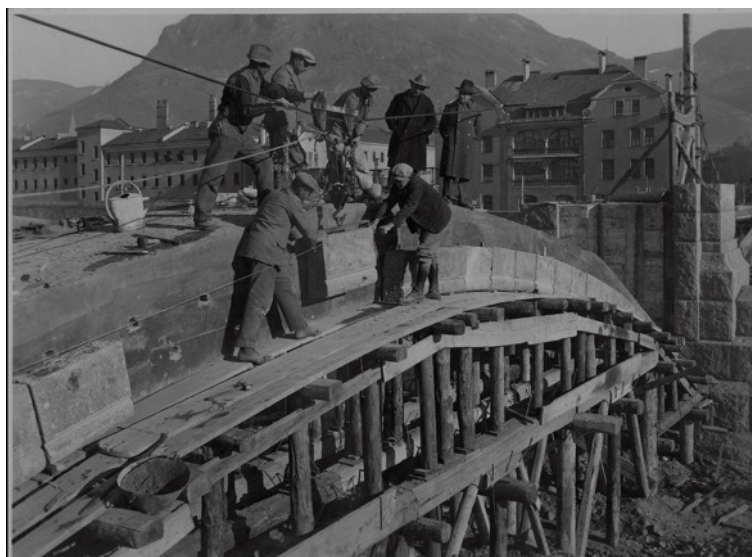
Figura 21. Sergio Perdomi, Lavori di costruzione del ponte Druso, Bolzano, 1933 , gelatina al bromuro d'argento su carta, Raccolta miscellanea, AFS, UMSt soprintendenza per i beni e le attività culturali, Provincia autonoma di Trento
