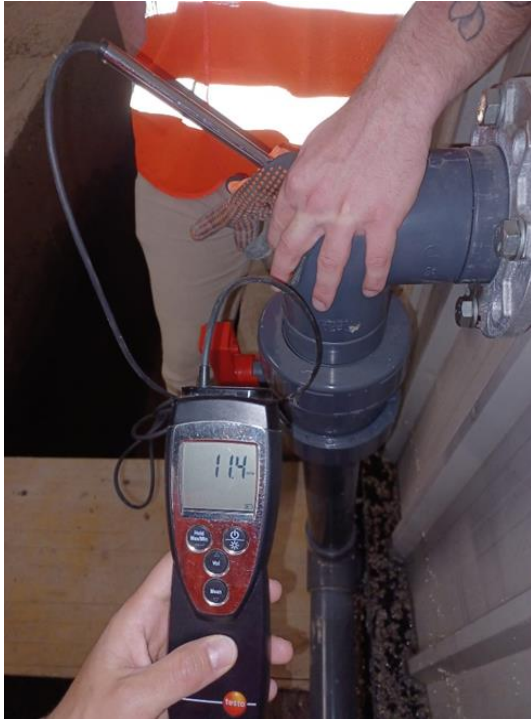
Figura 10. Dettaglio sulla misurazione del flusso tramite anemometro ad elica nel retro di una biopila.
