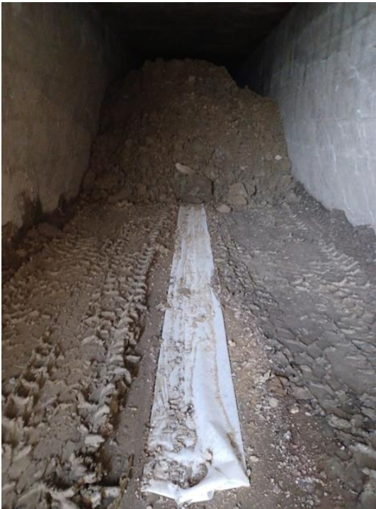
Figura 7. Dettaglio dell'interno della biopila e geotessuto sottostante il cumulo.
