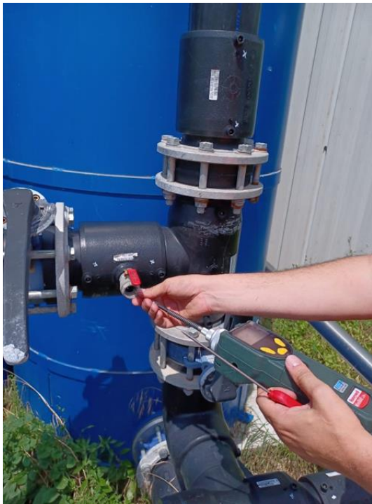
Figura 17. Valutazione dei VOC nella linea dei biofiltri tramite l'utilizzo del PID.
