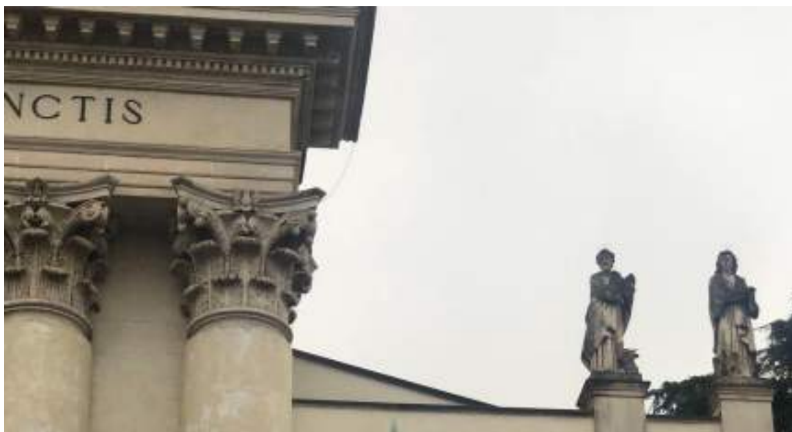
Fig. 27. Arzignano, Duomo di Ognissanti , dettaglio della fascia di raccordo tra capitelli e colonne.
