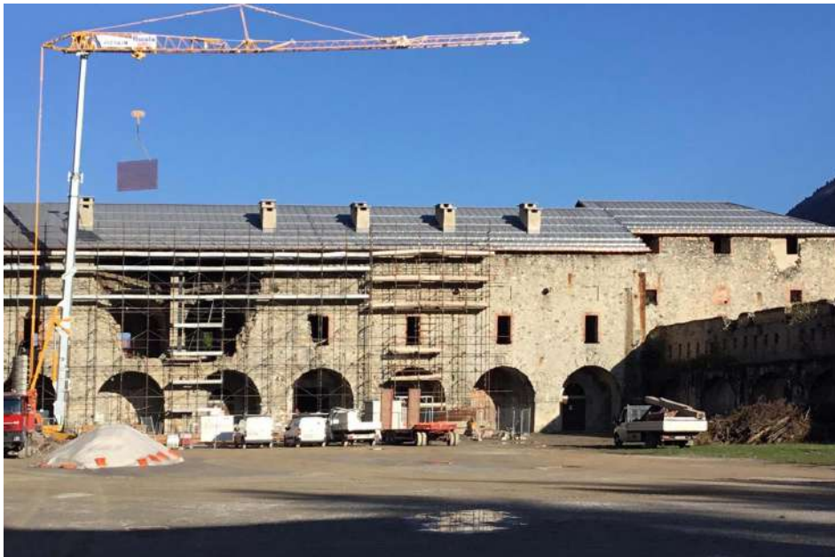
Fig.24. Cantiere per il rifacimento del tetto del Forte Albertino di Vinadio. Fonte: https://www.oml-srl.it/rifacimento-del-tetto-del-forte-albertino-di-vinadio/
