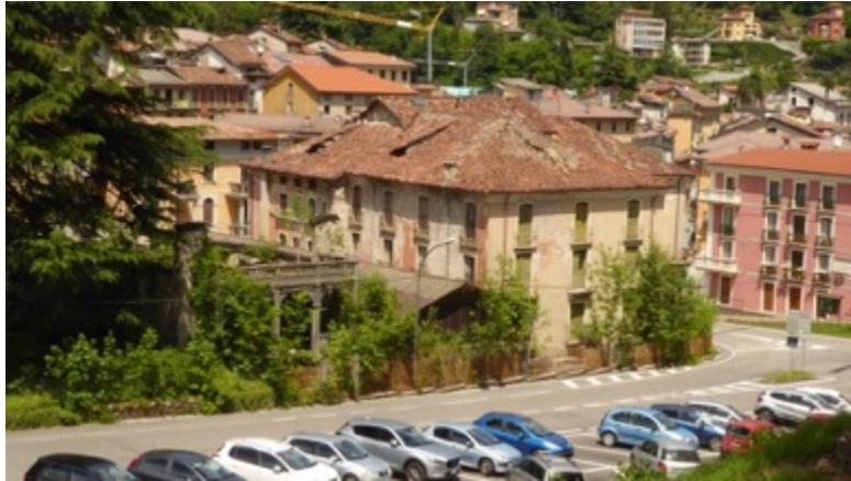
Figura A.32: a pochi passi dal centro non mancano edifici che hanno ceduto o che presentano un serio rischio di crolli
