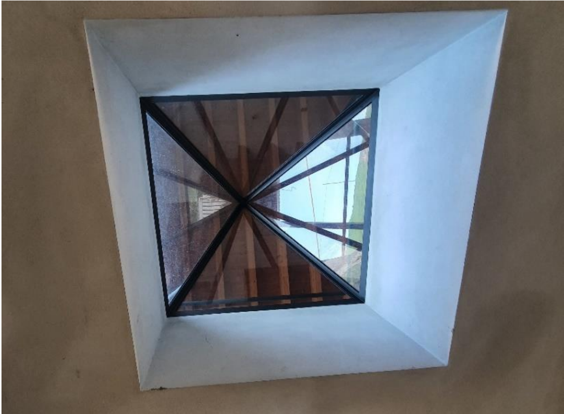
Fig.51. Botola all'interno del caseificio studiata da Gabriele per permettere a locali e turisti di poter vedere "dal vivo" la produzione dei formaggi, mentre fanno acquisti allo spaccio vendita situato al piano sopra. Fonte: fotografia personale del 13.05.2022.
