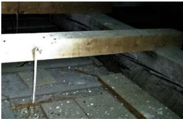
Figura 121 - Il sistema di ancoraggio ai travicelli dei pannelli in compensato ai quali sono attaccate le tele.
