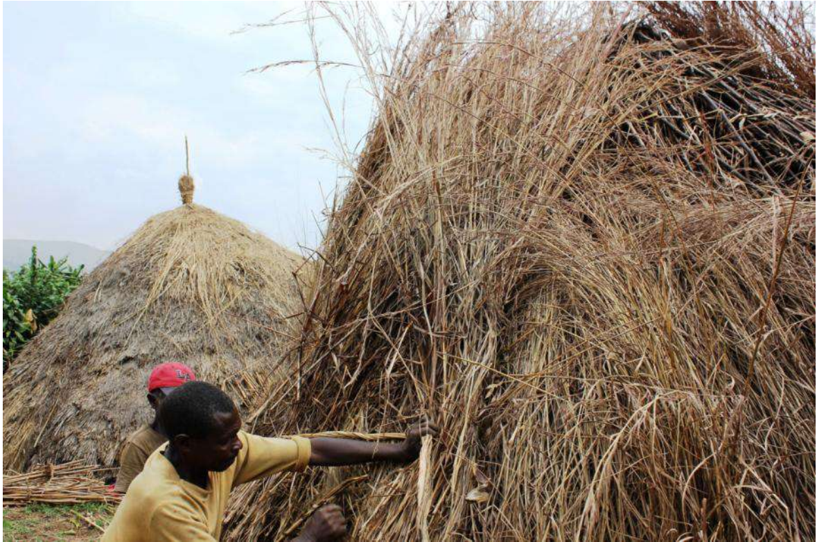
Figura 33. Fase di fissaggio delle fascine di paglia tramite cucitura dall'interno all'esterno, Mudaka
