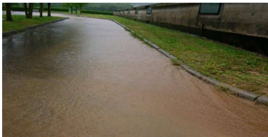
Figura 66: Stato della strada adiacente al cimitero durante un evento piovoso
