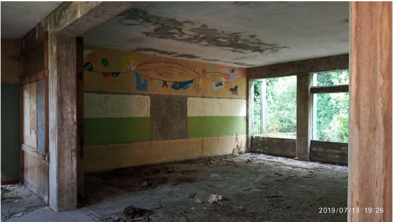
Figura 8. Un'aula dell' escuela abandonada , la cui pavimentazione era stata parzialmente rimossa. Sullo sfondo visibili alcuni sparuti rampicanti che tentano l'ingresso nella sala. Sul soffitto, alcune macchie di umidità; allap arete, alcune decorazioni di quando l'aula era usata per le lezioni. Fotografia scattata in compagnia di Santiago.
