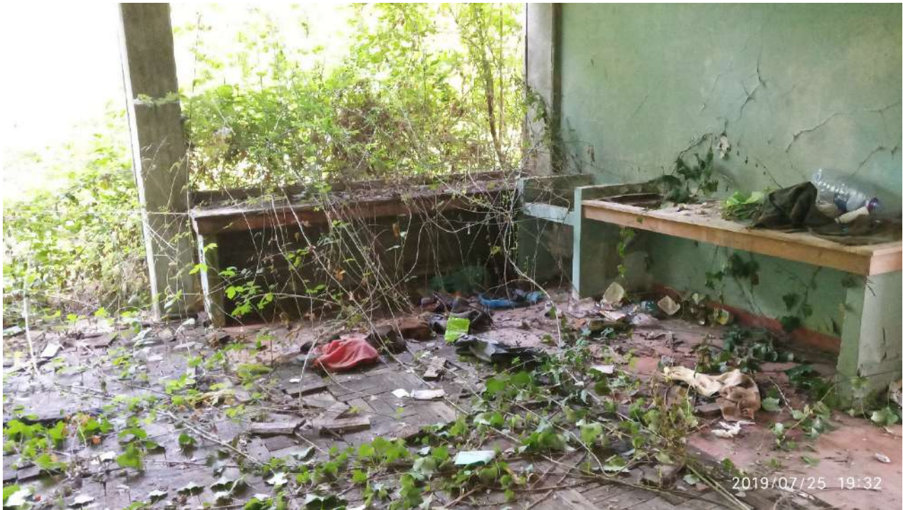
Figura 17. La natura invade il paesaggio che gli uomini lasciano incolto dietro di sé nell' escola abandonada . In questo angolo di una delle sale era visibile la pavimentazione fatta di lastrelle in legno, parzialmente rimossa, e i rovi che se ne stavano impossessando, entrando sia dal muretto in cemento sia dall'apertura più grande. A terra, insieme a diversi abiti, visibili anche dei piccoli sacchetti in plastica di un verde acceso: erano i sacchetti di distribuzione dei kit del Programa Troca de Seringas . Un piccolo muretto laterale con un piano di appoggio in legno ospitava altri rampicanti e altri vestiti, come anche una bottiglia in plastica vuota. Fotografia scattata in compagnia di Santiago, Carlos e Diogo.
