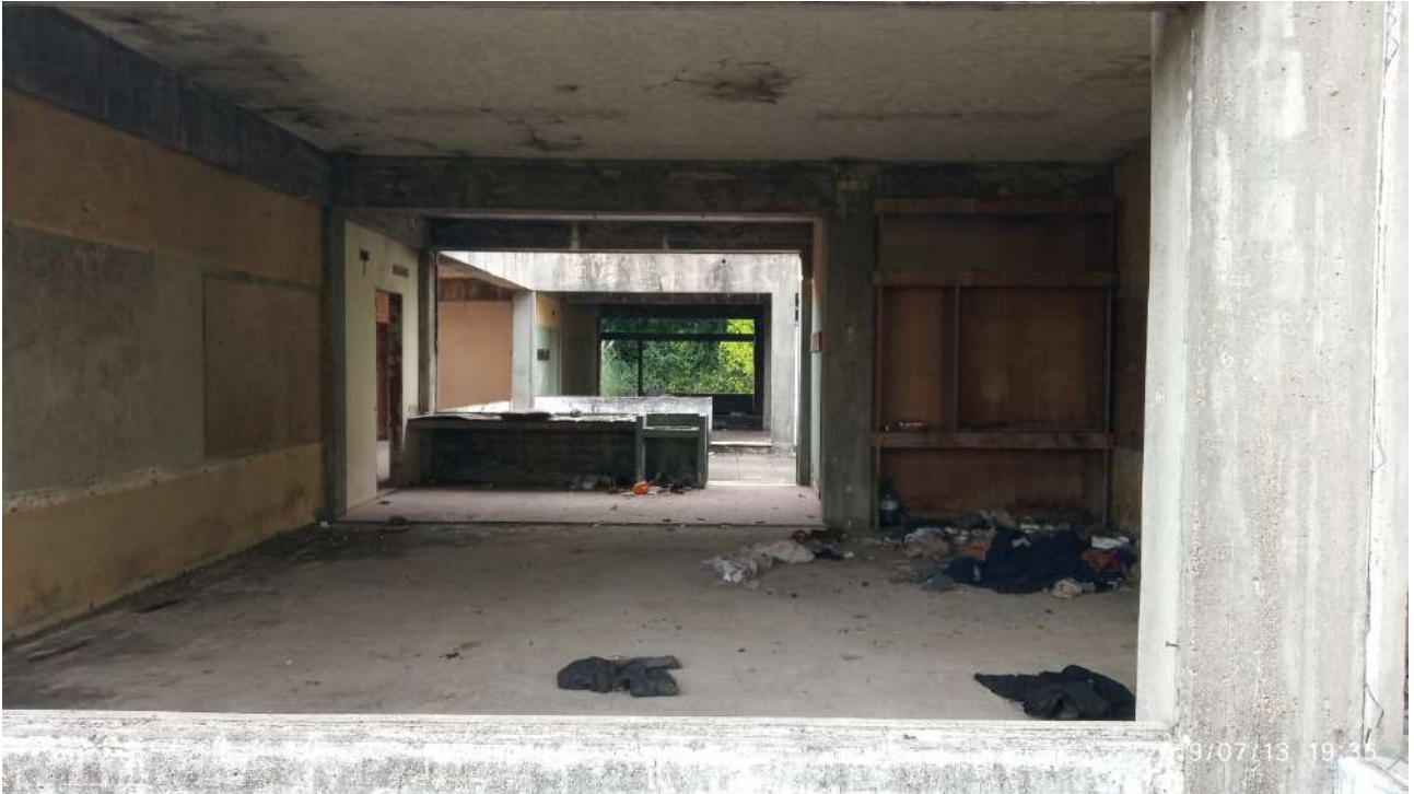
Figura 12. Prospettiva dell' escuela abandonada : una sala conduceva a un corridoio, a un cortiletto interno, a un'altra sala che infine dava sul boschetto rigoglioso che circondava il tutto. Nella sala vi erano alcuni abiti a terra, dove la pavimentazione in legno era stata, come sempre, rimossa. Alla parete di sinistra alcuni vani vuoti presumibilmente contenevano delle vecchie lavagne a muro, che venivano riutilizzate per fornire dei piani di appoggio. Sulla destra vi era una piccola nicchia con una scaffalatura in legno. Il corridoio cingeva il cortile concentrico con un ripiano in cemento e alcuni piani d'appoggio. Fotografia scattata in compagnia di Santiago.
