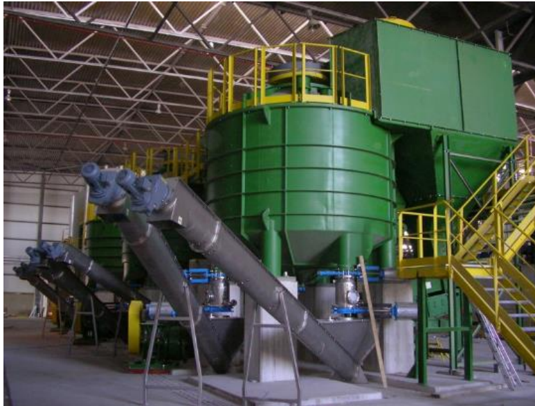
Figura 14 – Idropolpatori per il trattamento della FORSU
