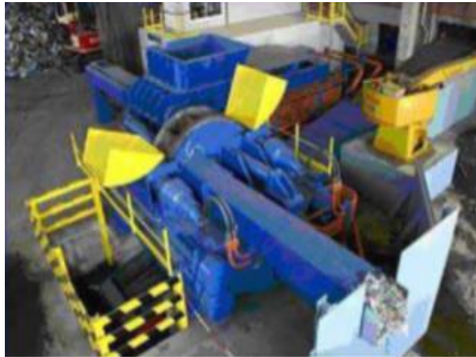
Figura 15 – Macchina per la presso estrusione
