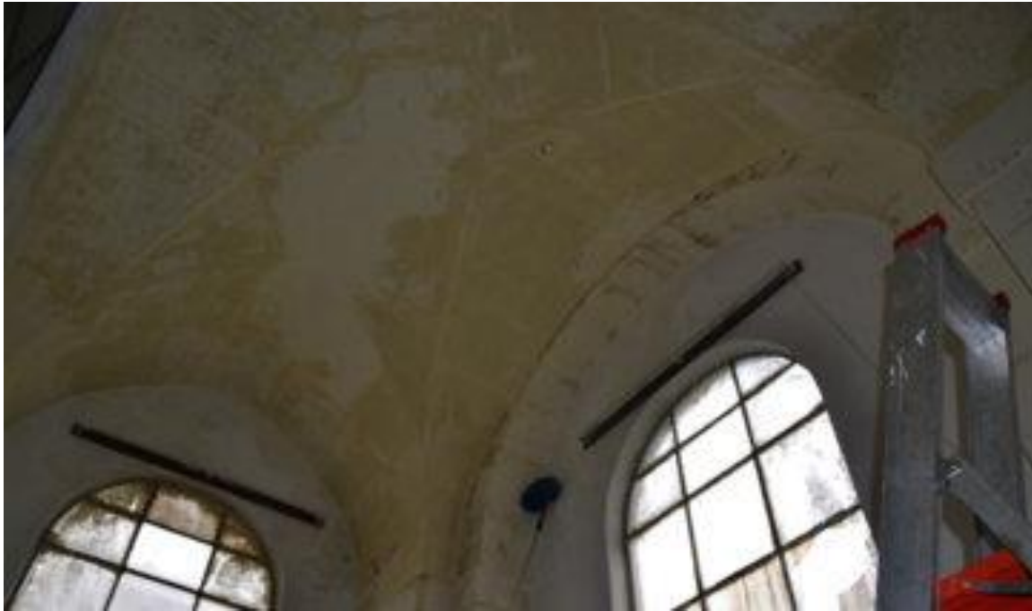
Figura 32. Il soffitto dei locali di conservazione dal quale proveniva la percolazione d'acqua. Immagine fornita da Prodoc.
