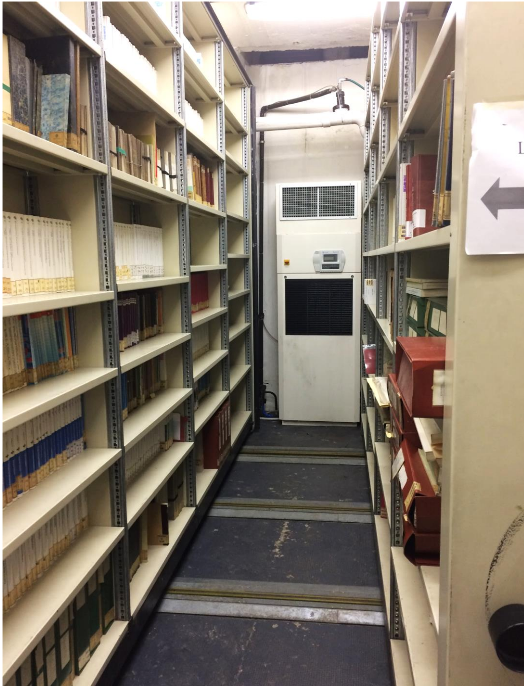
Figura 16. Il deposito d'archivio dell'Ateneo all'interno del quale è avvenuto il sinistro. Sul fondo è possibile notare la tubatura da cui proveniva l'acqua che ha danneggiato i volumi. Immagine fornita da Prodoc.
